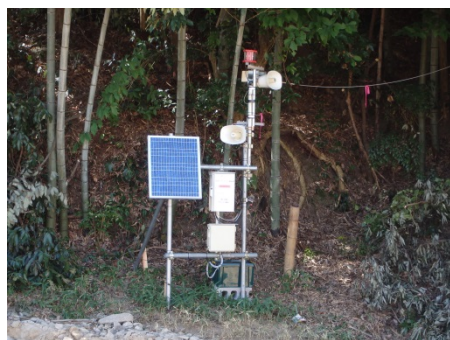
土石流警報装置設置状況
