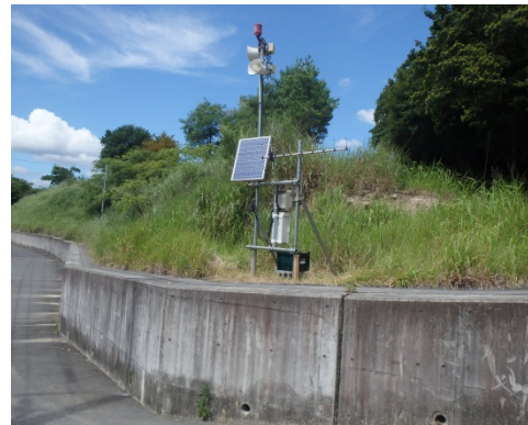
土石流警報装置設置状況
