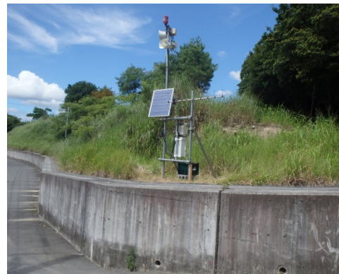
土石流警報装置設置状況
