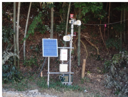
土石流警報装置設置状況
