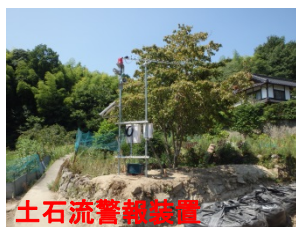
土石流警報装置設置完了(7/19)
