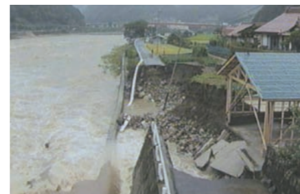
平成17年台風14号被災状況
