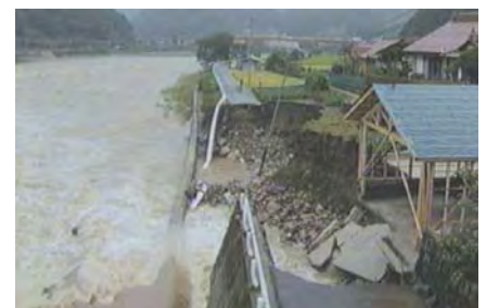
平成17年台風14号被災状況
