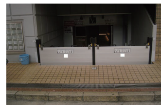
止水板の設置に対する助成（広島市）
