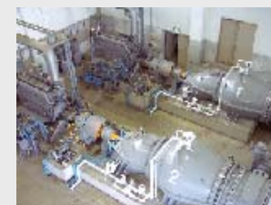
揚排水ポンプ設備
