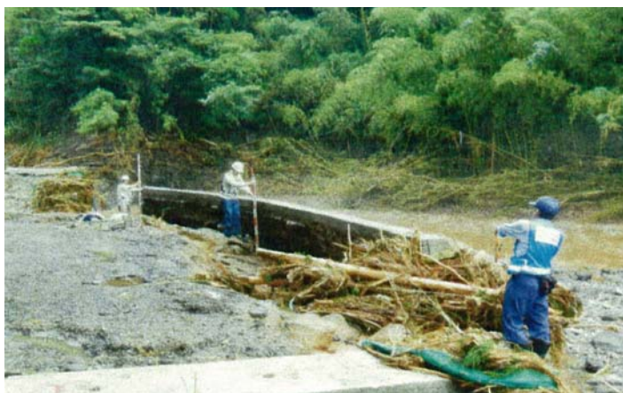
道路復旧のための被災状況調査 (大分県竹田市)
