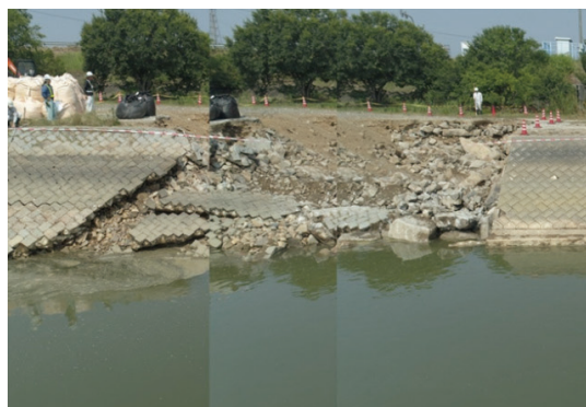
高梁川 護岸崩落
