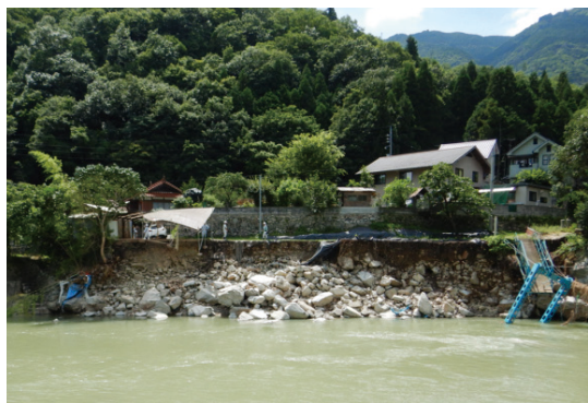
太田川 護岸崩壊
