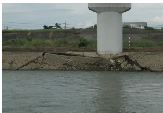
千代川 護岸崩落
