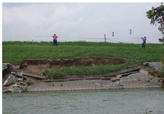
芦田川 護岸崩落
