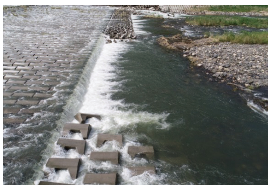
斐伊川 床止洗掘
