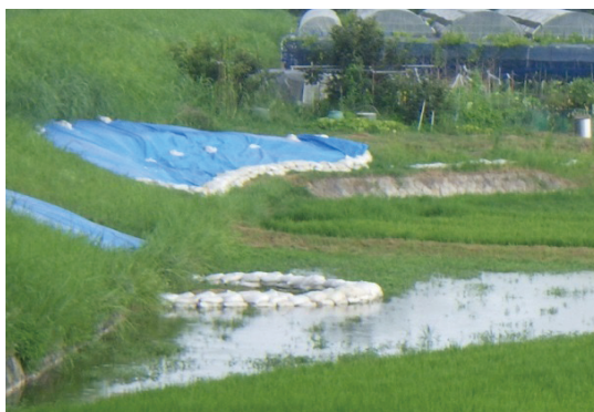
吉井川 漏水被害
