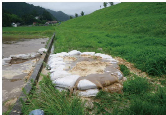
江の川（下流） 漏水災害
