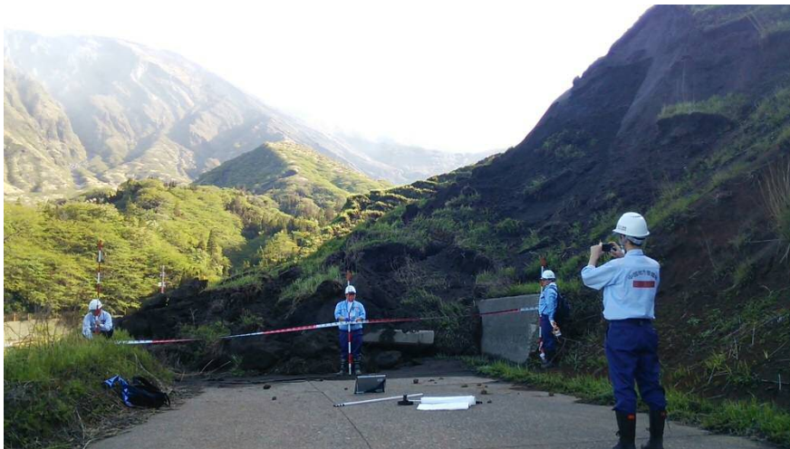
仙酔峡道路 被災状況調査
