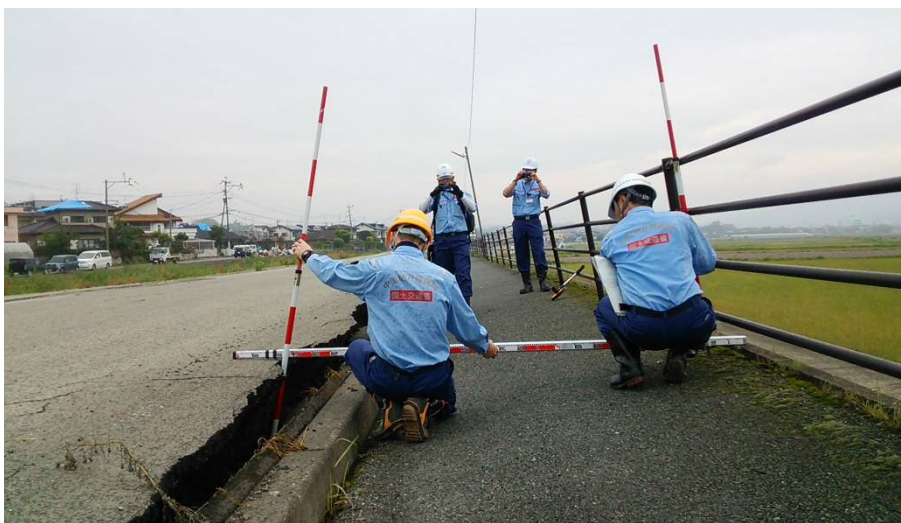
秋津川被災状況調査(益城町内)
