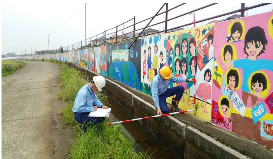
秋津川被災状況調査(益城町内)
