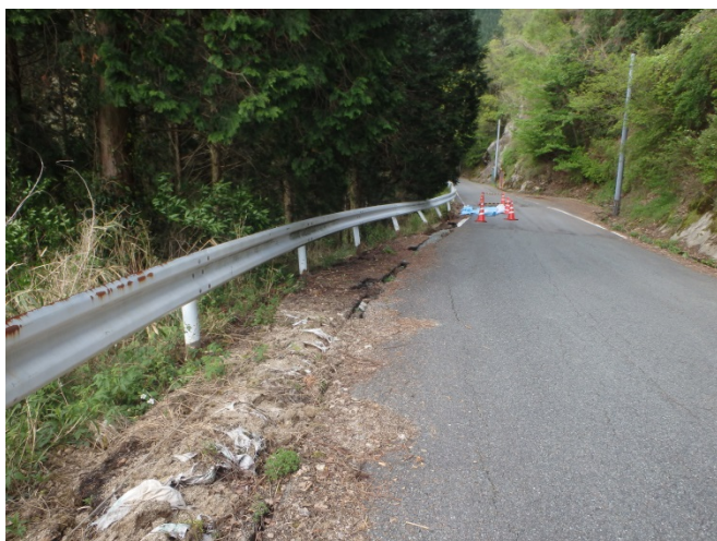
九枝～阿蘇市役所で確認した被災箇所
