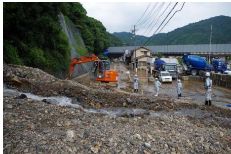
●国道2号土砂崩落状況(14時時点) 【山口県岩国市多田】
