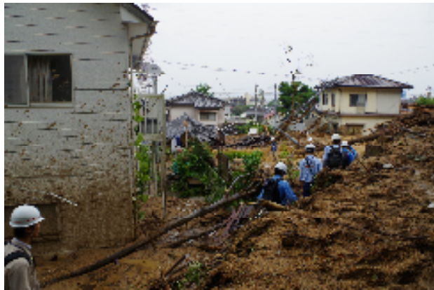
●被災状況調査状況 【山口県岩国市新港町】
