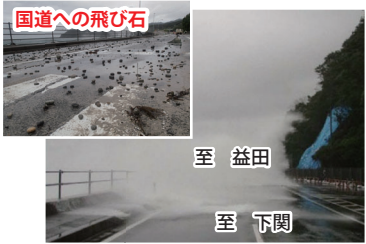
国道191号の越波状況
