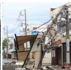
<飛来物による電柱倒壊の事例>
