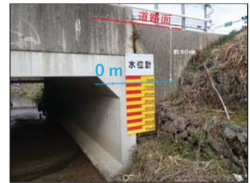
【内山谷川現地水位計】
