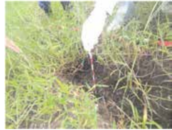
法面の侵食箇所
