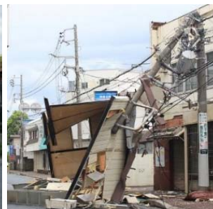
＜飛来物による電柱倒壊の事例＞
