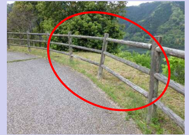
転落防止柵が傾いていた
