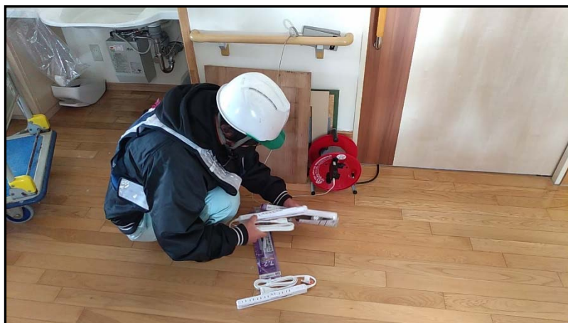
令和6年1月能登半島地震 特別養護老人ホームへの電源供給 (石川県珠洲市)
