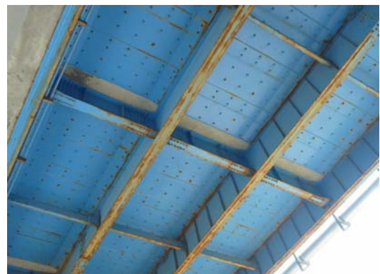
桁の腐食状況
