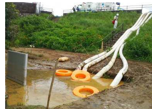
平成26年8月広島豪雨災害における 排水ポンプ車の釜場の状況
