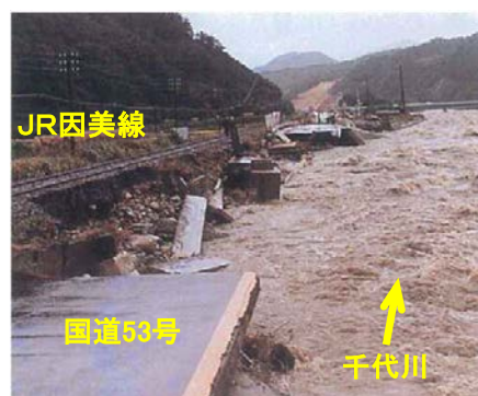
河岸浸食状況 (鳥取市用瀬町鹿の子)
