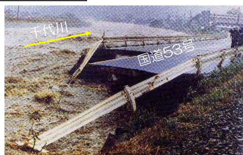
国道が侵食により流出(旧用瀬町)
