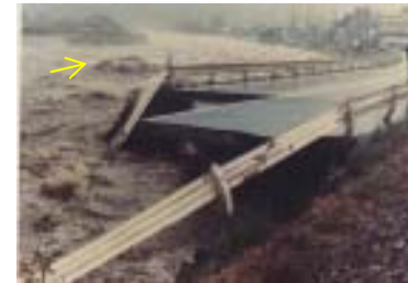
昭和54年10月18日洪水 浸食された道路(安蔵付近)
