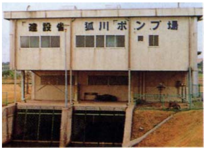
写真 2.4.3 今後、機器類の更新が必要な排水機場
