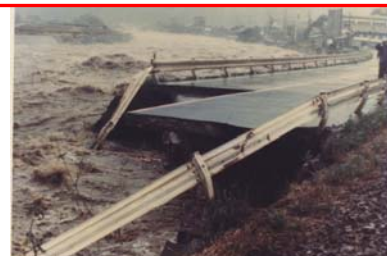
昭和54年10月18日洪水(台風第20号) 浸食された道路(安蔵付近)
