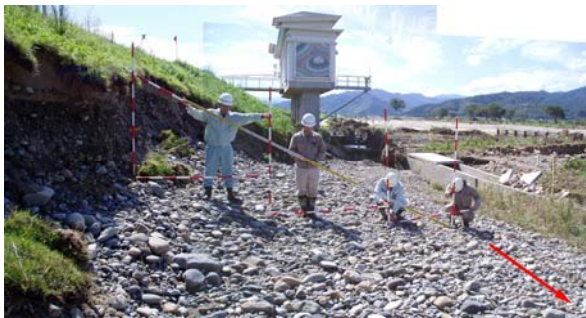
写真 2.4.2 平成 16 年 9 月洪水による堤防の崩壊状況 (倉田スポーツ広場付近)
