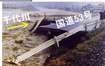
国道が侵食により流出(旧用瀬町)
