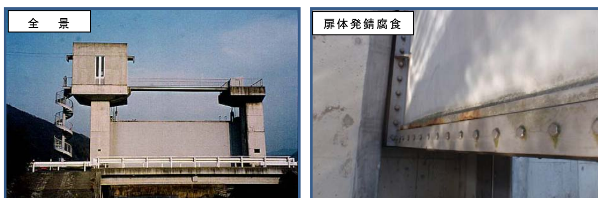
写真 2.4.5 樋門ゲートの劣化
