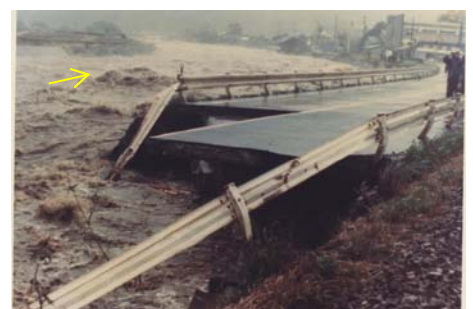
昭和54年10月18日洪水 浸食された道路(安蔵付近)
