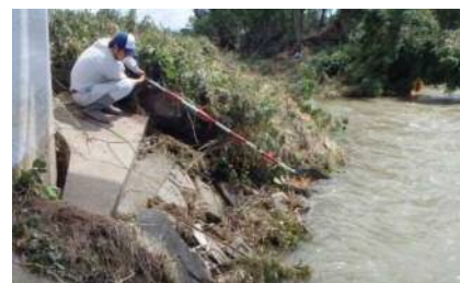
写真 5.2.4 被災箇所の測量 (平成30年7月洪水：国安付近)
