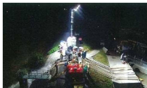
写真 5.2.8 照明車と排水ポンプ車
