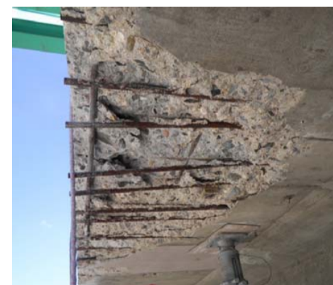
▲ 鉄筋の露出状況
