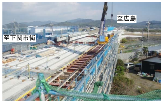
【写真②】木屋川大橋第2高架橋施工状況 (橋を架けています)
