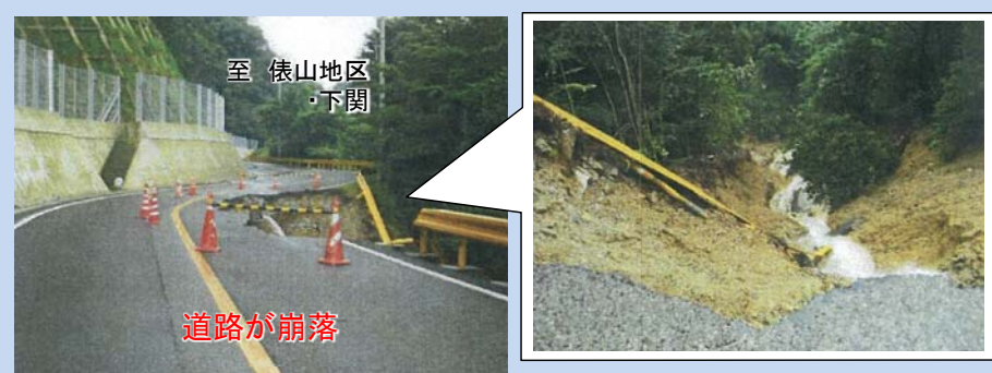
H21年7月中国・九州北部豪雨による大寧寺峠の被災状況(写真①)
