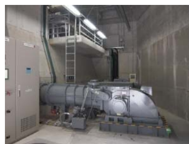
管理用発電施設内 水車・発電機
