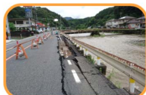
被災状況(H30年7月7日)
