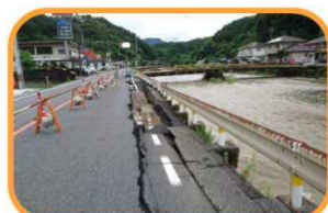
被災状況(H30年7月7日)
