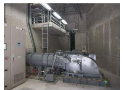
管理用発電施設内 水車・発電機 12
