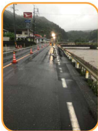
平成30年7月豪雨による 国道2号の被害(岩国市保木)
