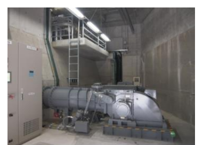
管理用発電施設内 水車・発電機
