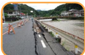
被災状況(H30年7月7日)
