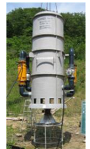
重金属類対策施設
