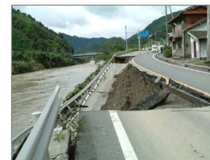
護岸流出の状況 国道2号(岩国市瓦谷)
