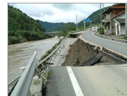
護岸流出の状況 国道2号(岩国市瓦谷)
