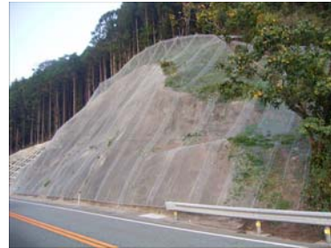
大規模斜面の落石防護工
