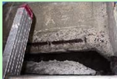
▲写真 鉄筋の露出状況
