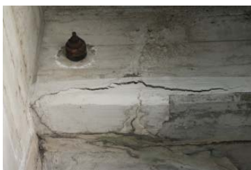
【損傷状況】橋本体のひび割れ
