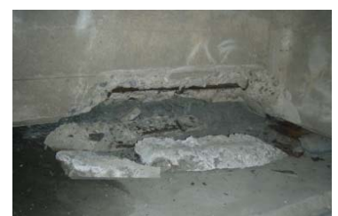
【損傷状況】コンクリート落下
