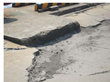
老朽化しエプロンに段差が生じた岸壁
