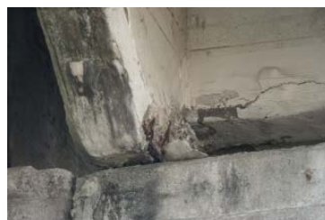
【損傷状況】橋本体のひび割れ
