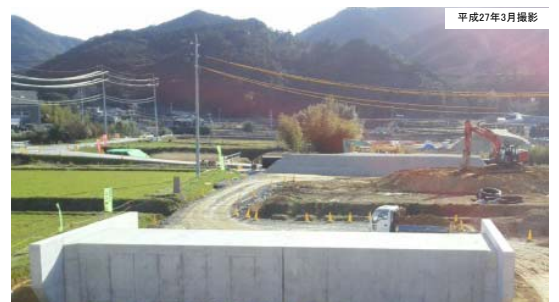
写真② 深川湯本地区施工状況 (道路の高さまで土を盛っています)
