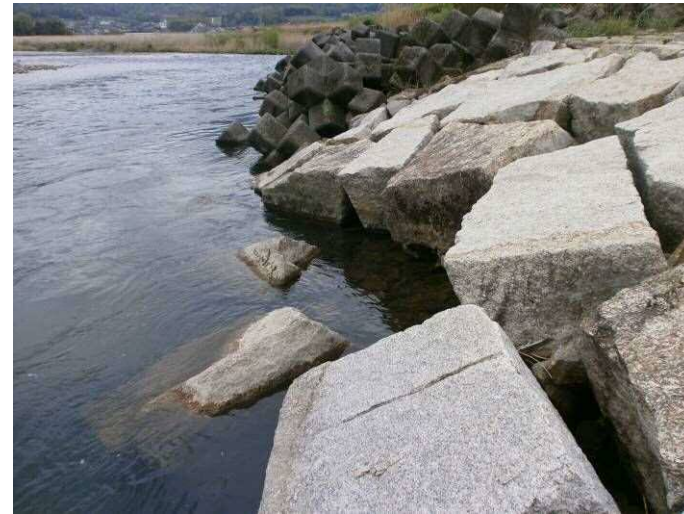
根固めブロックの崩れ
