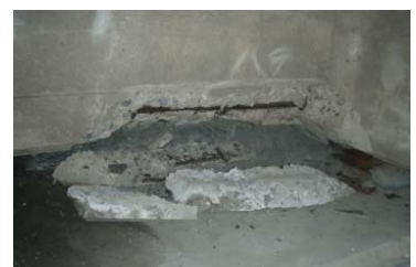
【損傷状況】コンクリート落下
