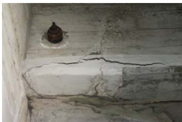
【損傷状況】橋本体のひび割れ
