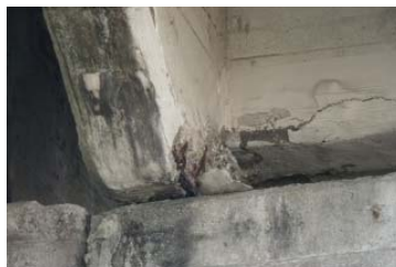
【損傷状況】橋本体のひび割れ
