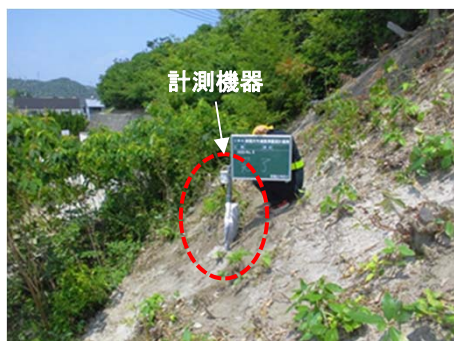
自記水位観測状況(例)
