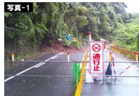
▲長門市俵山【H25.7 被災状況】
