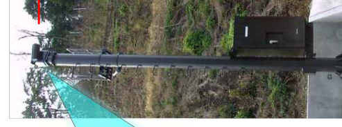
CCTVカメラ装置
