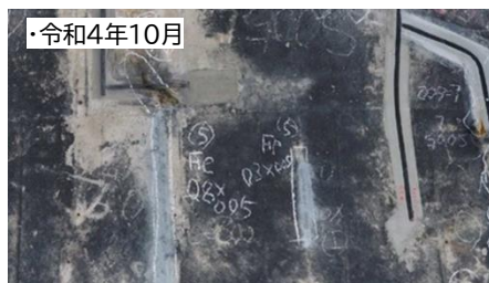
▲老朽化トンネルの鉄筋腐食状況
