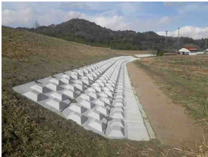
堤防裏法尻補強の施工完了箇所の状況 (山口市徳地伊賀地)
