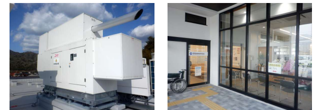
屋上に設置された発電機 総合支所と一体化した診療所
