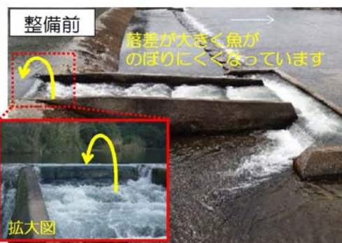
河道との落差が大きい魚道の例（総合堰）
